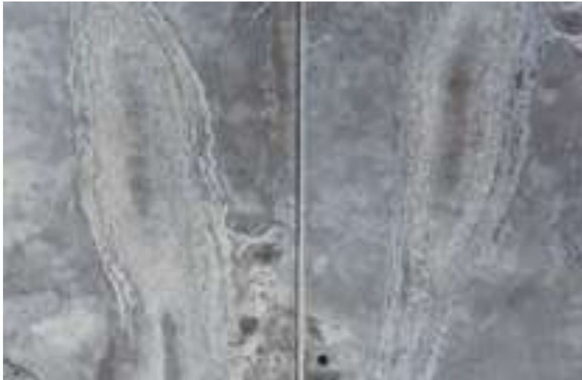
Fot. „Biała rdza” na powierzchniach ścianek wieży chłodzącej
