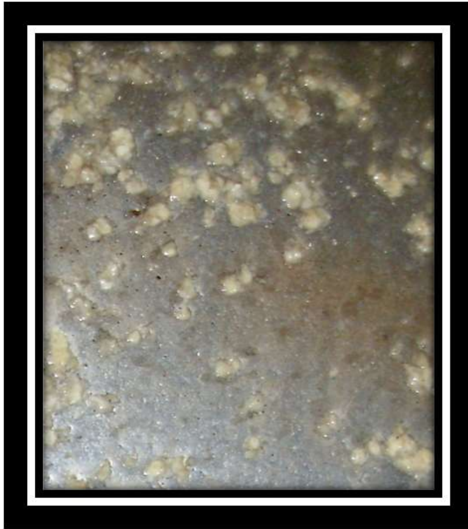
Fot. Żelowate osady „białej rdzy” na powierzchni ścianki tacy ociekowej skraplacza.
