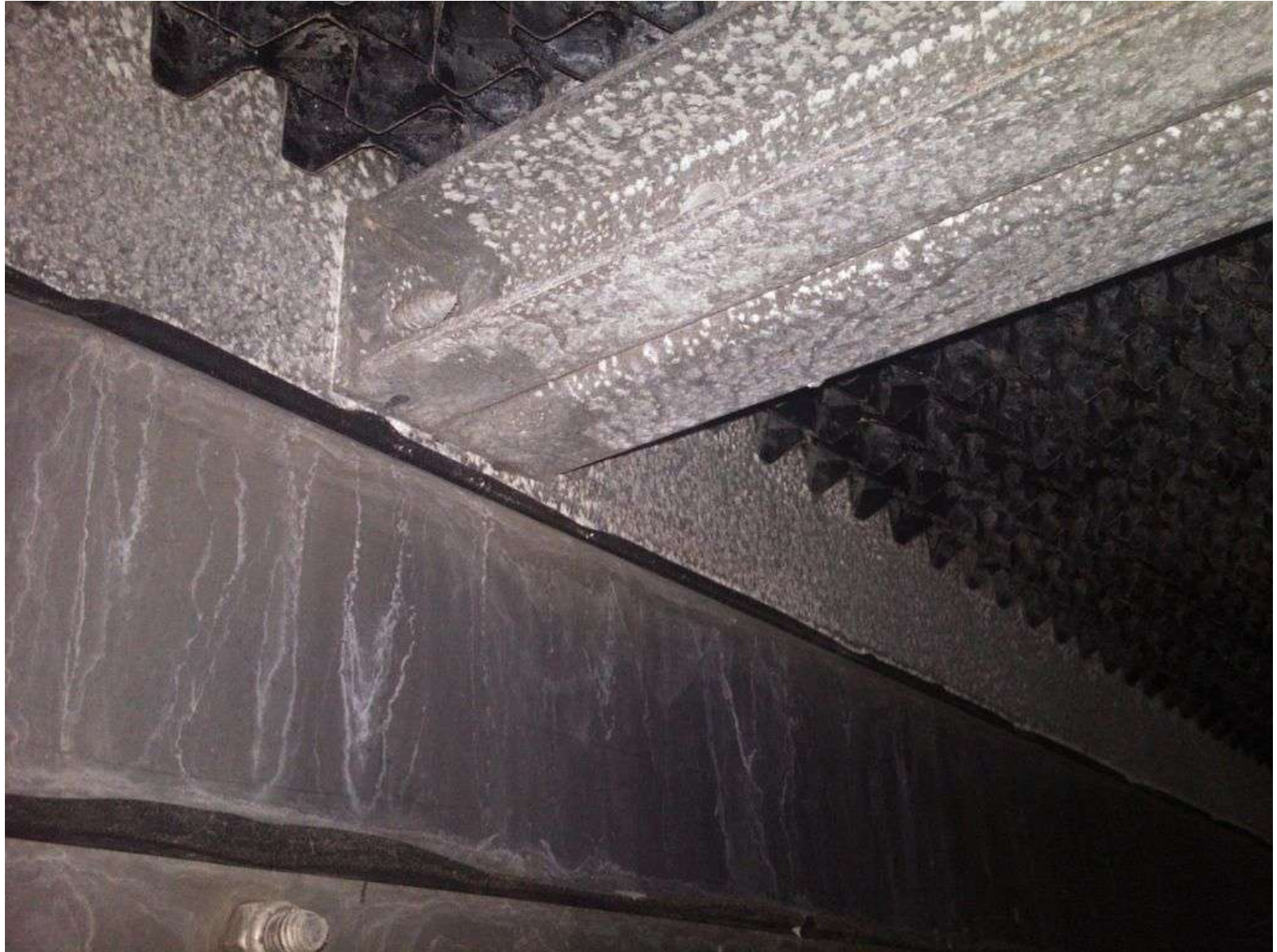
Fot. Wnętrze wieży wyparnej z wkładami ociekowymi , z widocznymi osadami „białej rdzy”.
