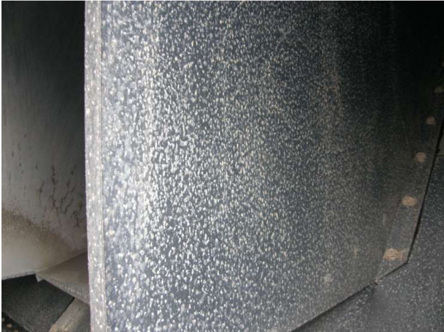
Fot. „Biała rdza” na powierzchni komory nawiewnej wentylatora, wewnątrz skraplacza.
