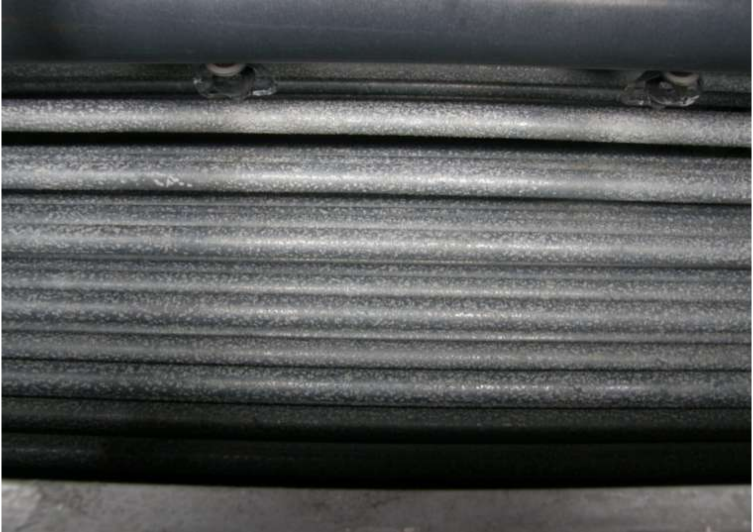
Fot. Punktowe wytrącenia „białej rdzy” na powierzchni węzownicy amoniakalnej skraplacza.
