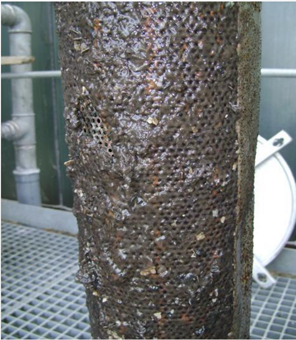
Zdjęcie powierzchni filtra siatkowego silnie obłożonego biofilmem
