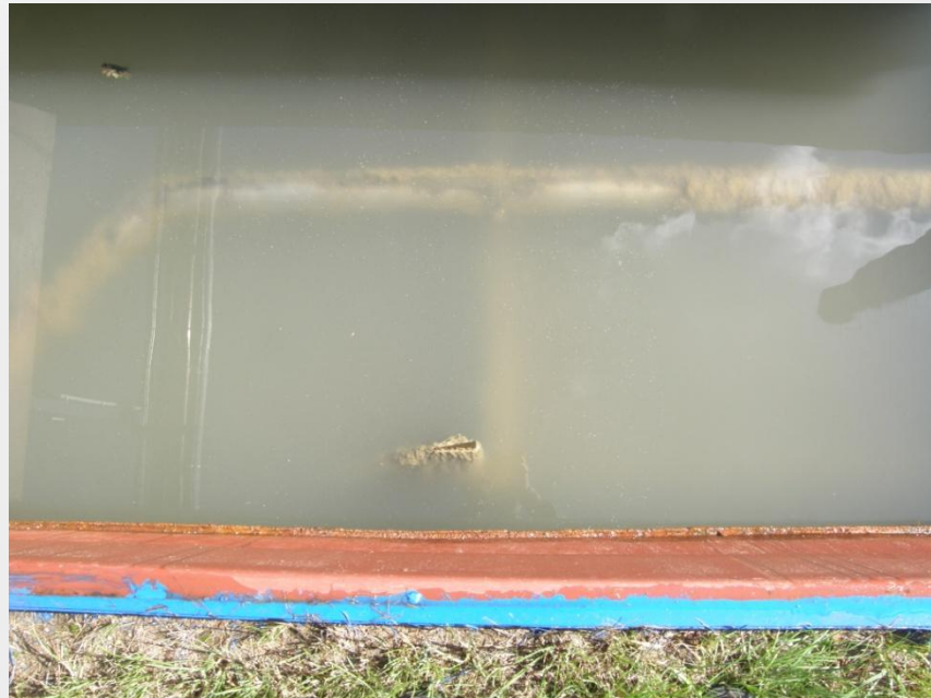
Mętna woda lodowa z widocznym biofilmem na rurach
