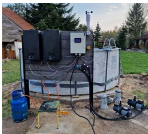
▼ System podgrzewania i filtracji wody w basenie ogrodowym
